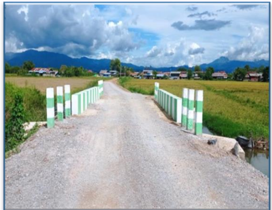
တောင်ကြီးမြို့နယ်၊ ပန်လွန်ကျေးရွာ Box Culvert တည်ဆောက်ခြင်း
