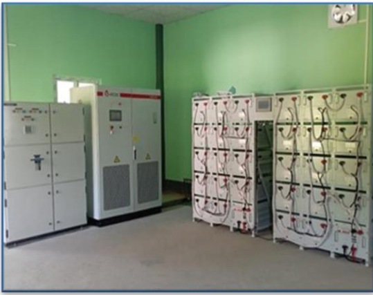
ကျိုက်လတ်မြို့နယ်၊ ကျိုက်လတ်ကလေး-ရွာသာကြီးကျေးရွာ ဆိုလာအသေးစားဓာတ်အားပေးစက်ရုံ
