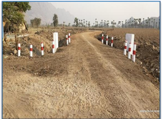
စဉ့်ကိုင်မြို့နယ်၊ ကန်တွင်းကျေးရွာ Box Culvert တည်ဆောက်ခြင်း
